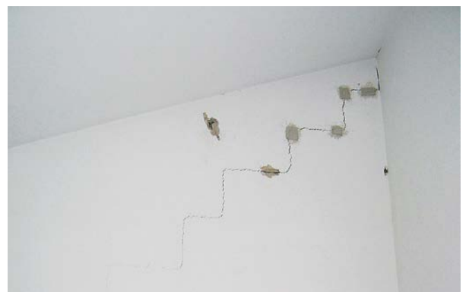
Bild 13 Rissbildung durch Verkürzung eines Stahlbetongurts
